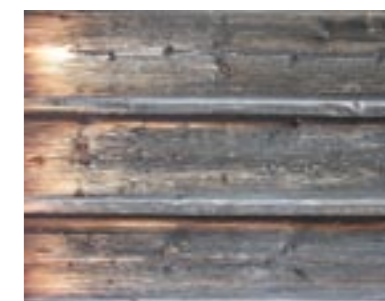
Verwitterung des Holzes der „Baumhütte“ Unbehandeltes Tannenholz, Lärche, zum Teil gebleicht oder gestrichen
